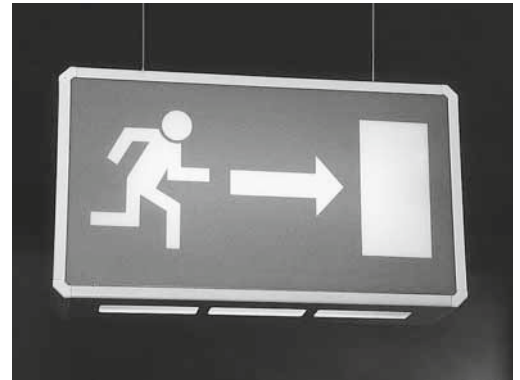
Bild 1: Tafel zur Kennzeichnung des Rettungswegs.
